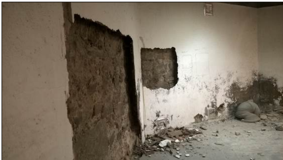
A la cala 2 es pot observar com el mur segueix la mateixa línia del xamfrà
